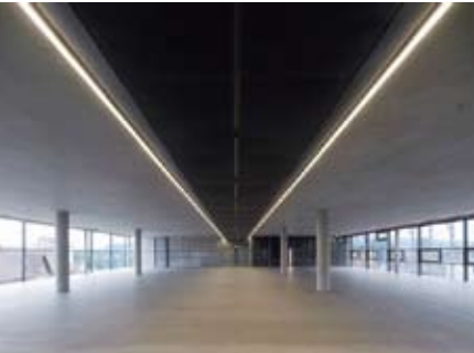
各階共通エリア（ビル中央にライン照明） シンプルな各階共通の天井ライン照明。これをベースとし各階のワークスタイルに合わせアンビエントライト、タスクライト、デコレーションライトが付加されています。
